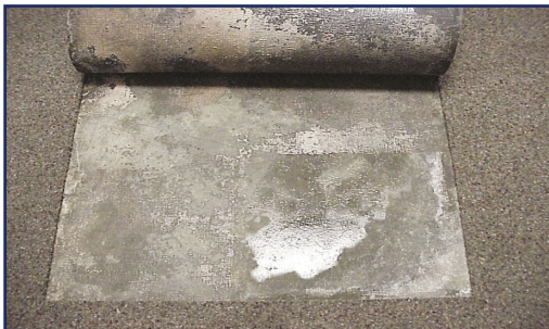
گسیختگی مرتبط با رطوبت در پوشش کف
